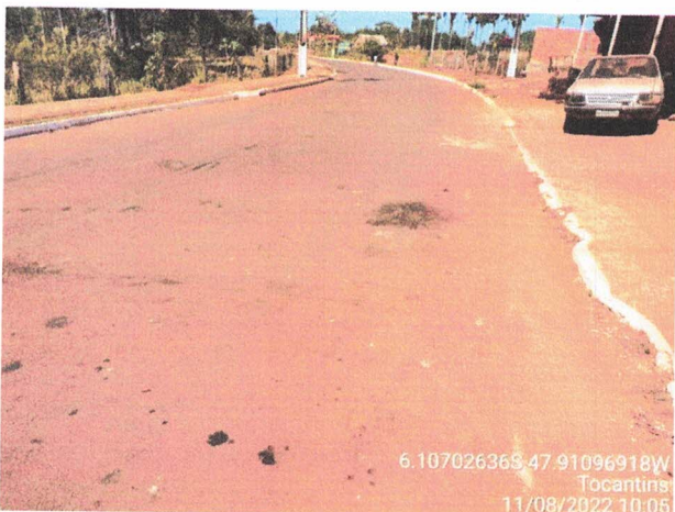
Foto 15: Pavimento com desgaste em alguns trechos.
