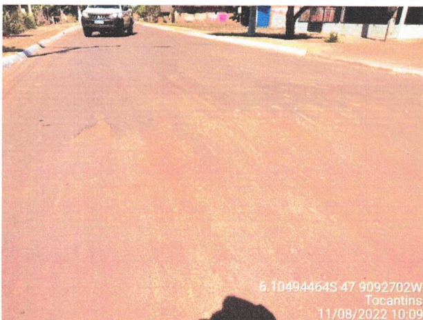
Foto 09: Pavimento com desgaste em alguns trechos.
