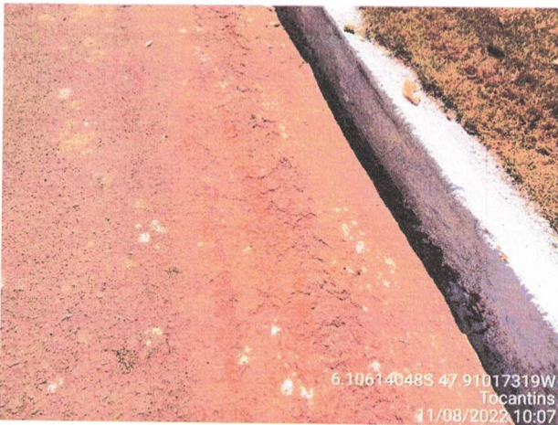
Foto 13: Pavimento com desgaste em alguns trechos.
