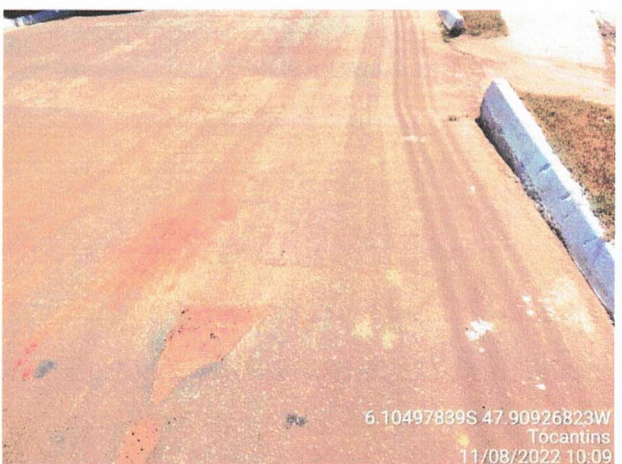
Foto 10: Pavimento com desgaste em alguns trechos.
