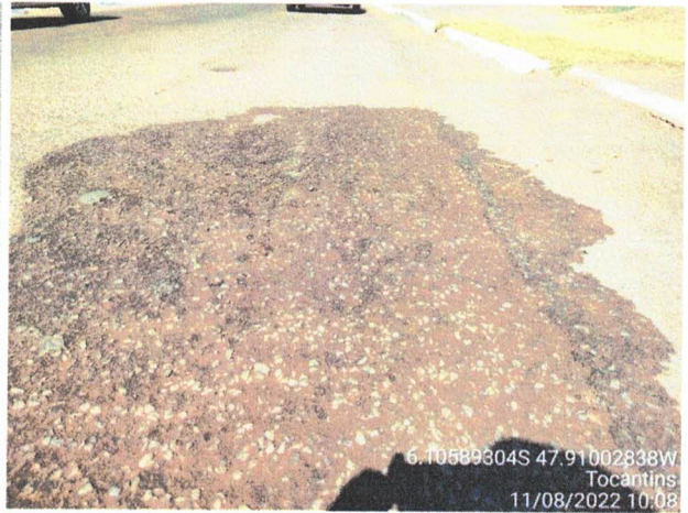
Foto 12: Pavimento com desgaste em alguns trechos.
