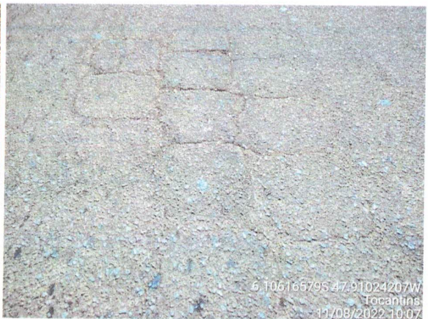
Foto 14: Pavimento com desgaste em alguns trechos.
