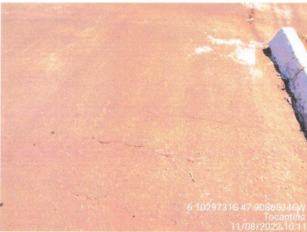
Foto 07: Pavimento com desgaste em alguns trechos.
