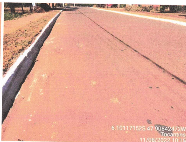
Foto 04: Pavimento com desgaste em alguns trechos.
