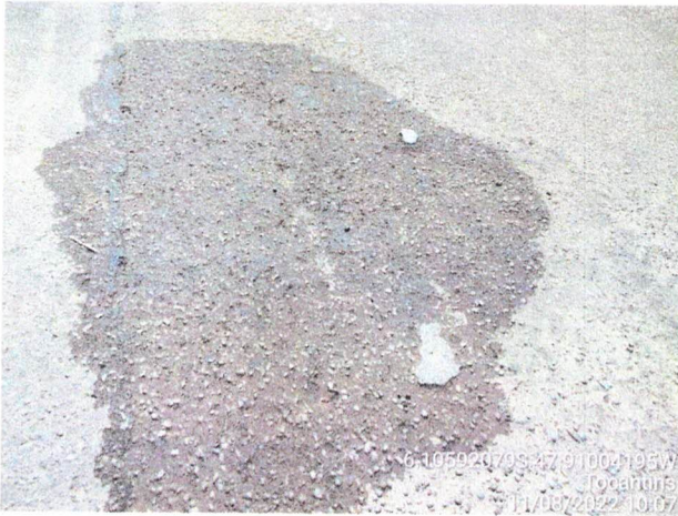
Foto 11: Pavimento com desgaste em alguns trechos.
