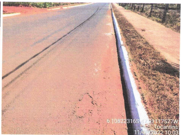
Foto 16: Pavimento com desgaste em alguns trechos.
