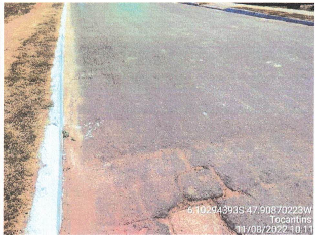
Foto 06: Pavimento com desgaste em alguns trechos.
