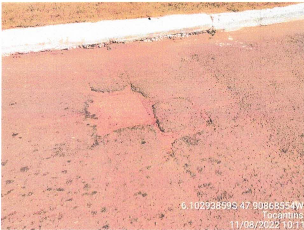
Foto 05: Pavimento com desgaste em alguns trechos.
