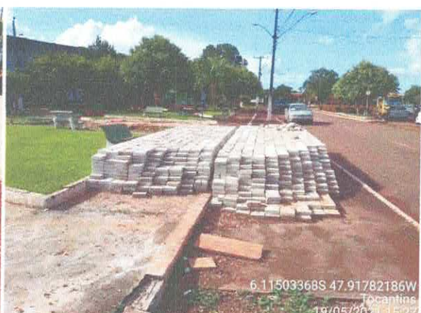
Foto 10: Blocos do piso intertravado que estão sendo instalados na área da academia da saúde.
