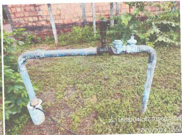
Foto 21: Reparos da Tubulação e Registro danificados.
