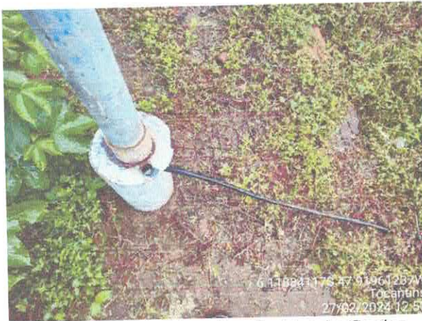
Foto 22: Reparos da Tubulação e Registro danificados.
