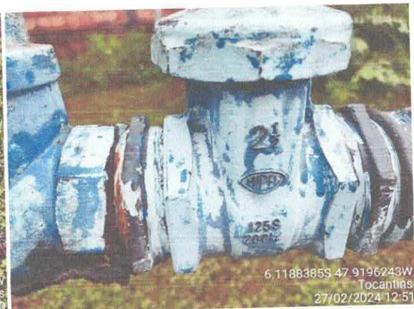
Foto 23: Reparos da Tubulação e Registro danificados.
