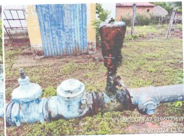
Foto 27: Reparos da Tubulação e Registro danificados.
