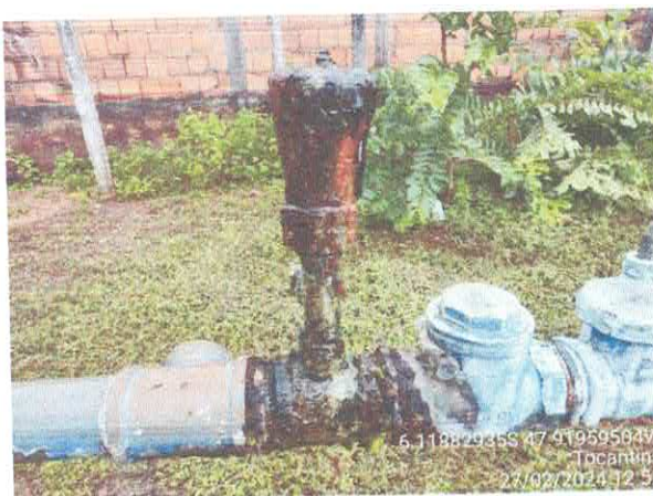
Foto 26: Reparos da Tubulação e Registro danificados.
