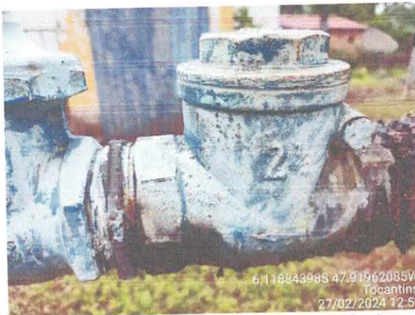
Foto 24: Reparos da Tubulação e Registro danificados.
