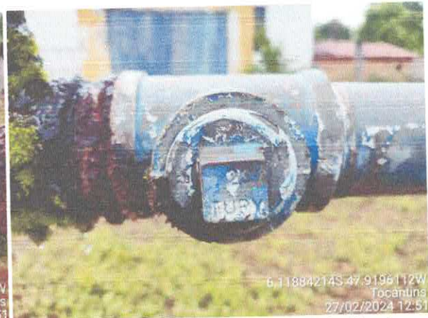
Foto 25: Reparos da Tubulação e Registro danificados.
